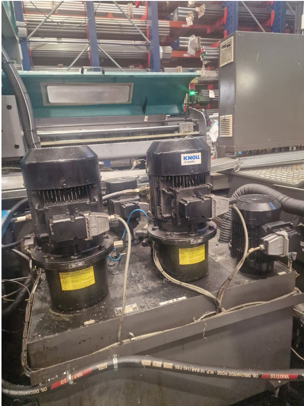
Pumpen-/Filtereinheit des Kühlmittel- bzw. Spänesystems.
