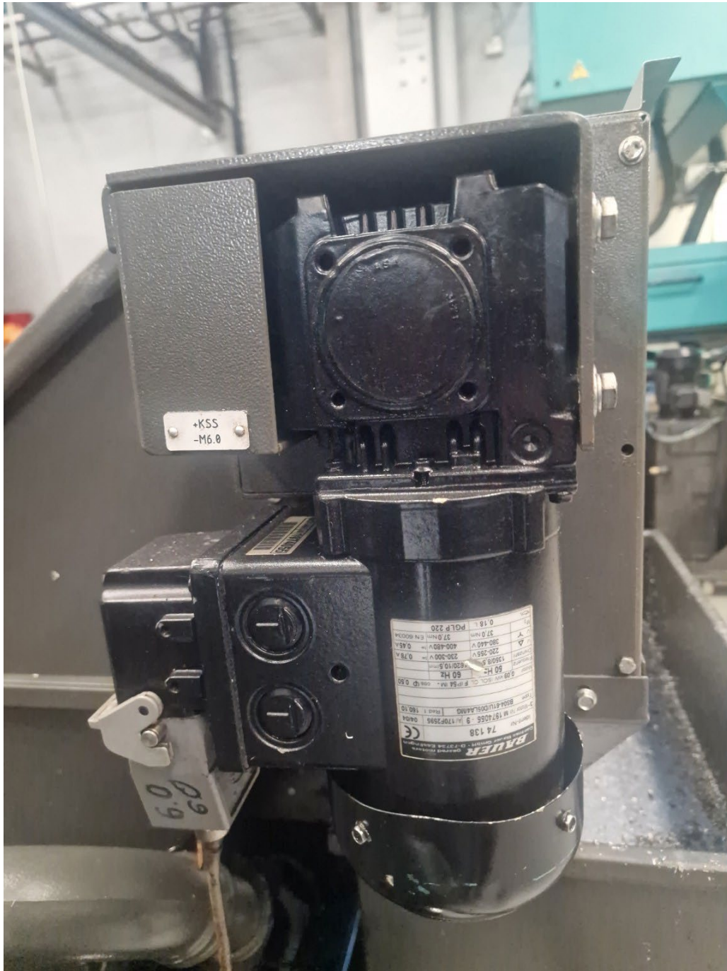
Getriebemotor / Nebenaggregat im Maschinenbereich.
