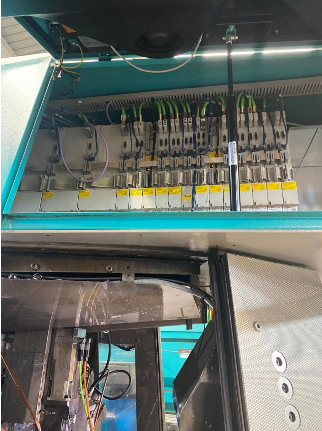
Geöffneter Maschinenbereich / elektrische und pneumatische Komponenten.
