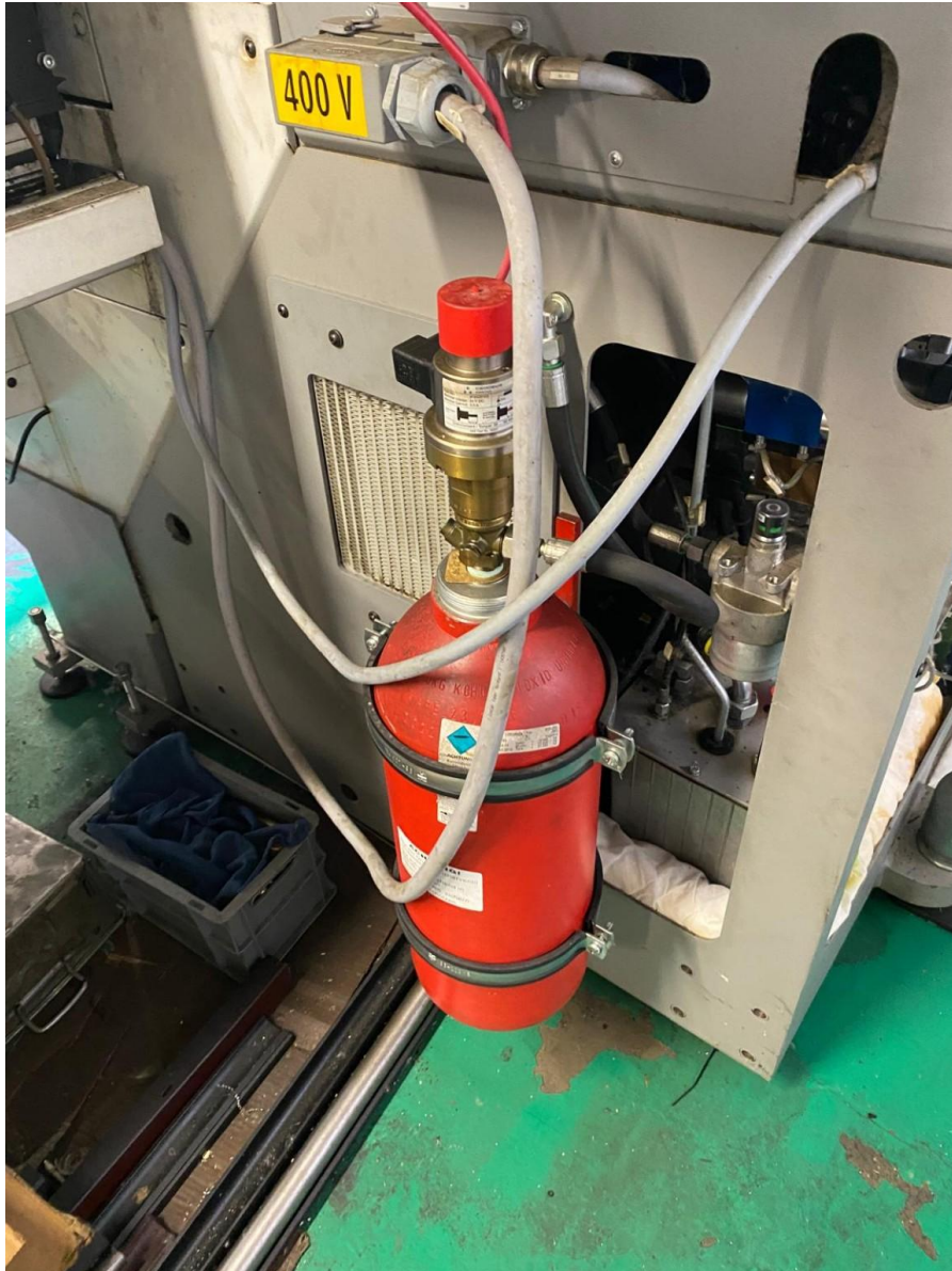
Feuerlöschkomponente beziehungsweise Löschmittelbehälter an der Maschine.
