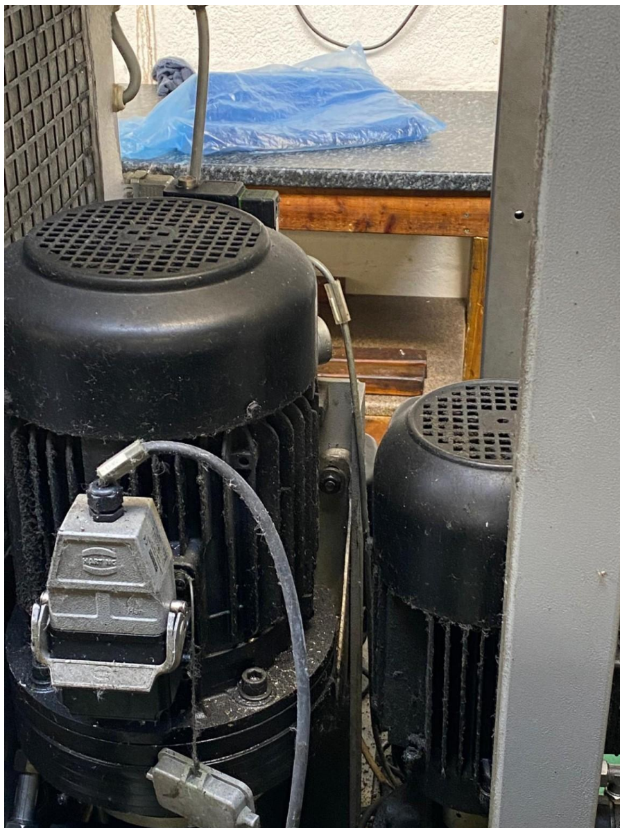
Pumpenaggregate und Leitungsanschlüsse im rückseitigen Maschinenbereich.
